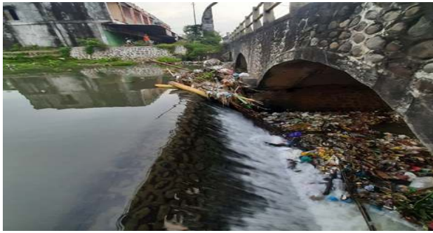
Gambar 2. Kondisi Mercu Bendung Gegutu
